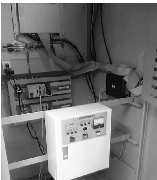
図 4. 設置例 1 (配電ボックス内)
