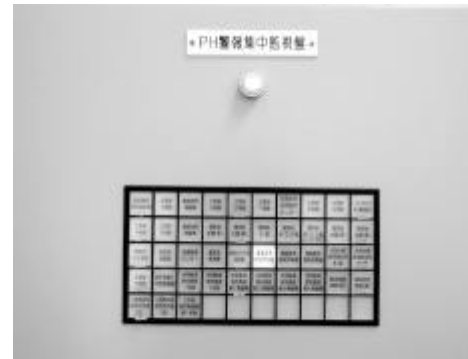
廃棄物処理施設実験室のモニタ盤外観
