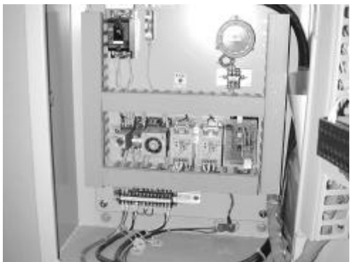
モニタ盤外観 (上)
