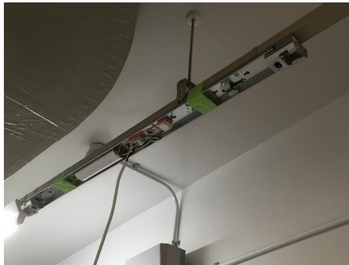
(a)隔離した電源部
